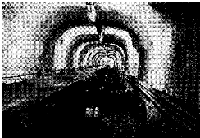
Kuva 15. Hihnakuuljetinkanaali. Fig. 15. Conveyor Tunnel.
