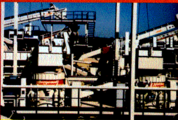
Société Routière et de Dragages de l'Est, France – aggregate production
