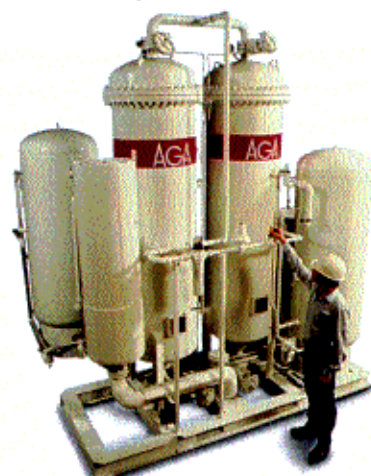
Suomessa on käytössä yli 60 AGAn asentamaa On Site -tuotantoyksikköä, joissa hyödynnetään PSA-, PVSA- tai membraanitekniikkaan perustuvia menetelmiä.
