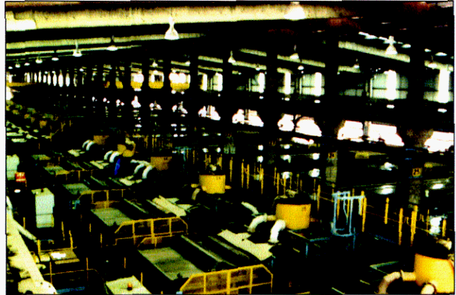
Kuva 4. Maailman suurin nauhasuodatinreferenssi fosforihappokoh-teessa Zairessa (Delkor nauhasuodatin). / Biggest vacuum belt filter reference of the world in a phosphoric acid plant in Zaire (Delkor vacuum belt filter).
