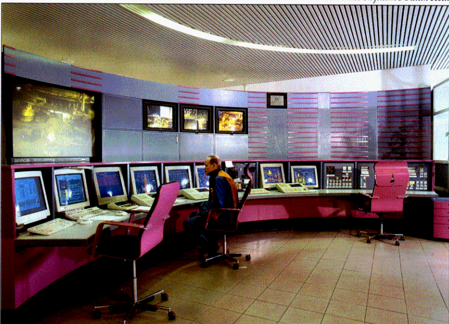
Terässulaton konverterilaitoksen uusi ohjaamo Raahessa.
