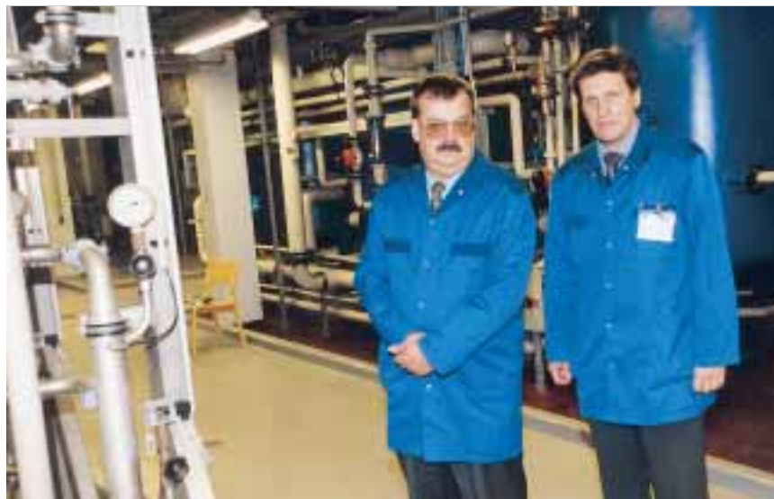
Markku Tilli (vas) ja Jukka Lahtinen vedenpuhdistamossa. Täällä vesi puhdistetaan niin puhtaaksi, että se on terveydelle vaarallista.
