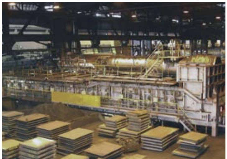
Kuvassa on ruotsalainen askelpalkkiuuni, joka on muunnettu Oxyfuel-järjestelmään käyttäen 26:ta liekitöntä Oxyfuel-poltinta.
