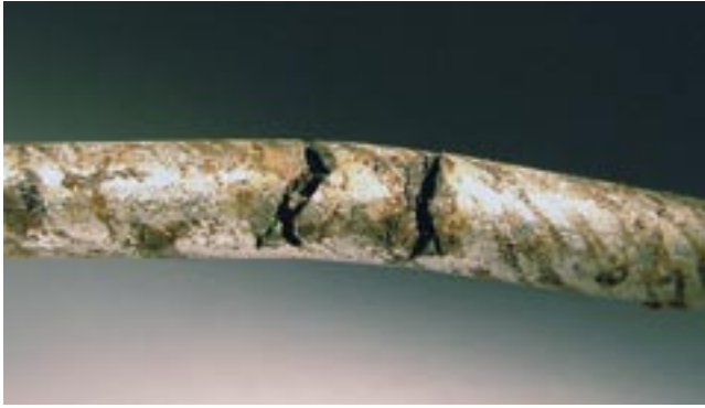
Kuva 4. Jännityskorroosion takia murtunut kylpylän sisäkaton kannake.
