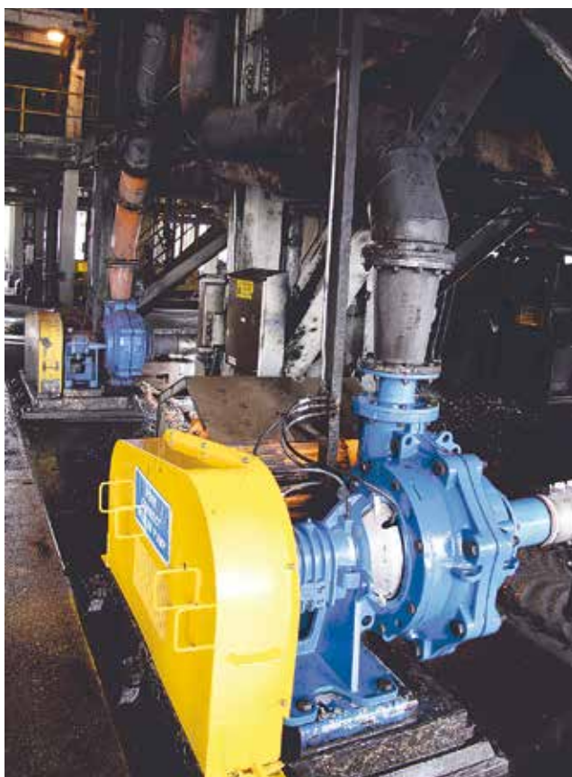
Etualalla WBH-pumppu, taka-alalla AH-pumppu. Kuva Weir
