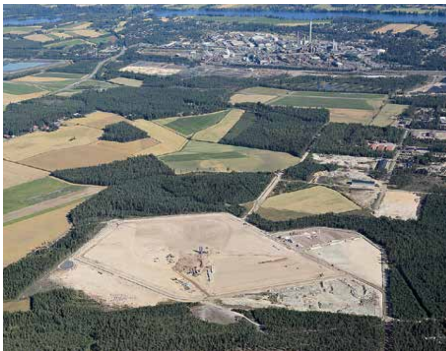
Kuva 2. Maabentonittimassakerroksen rakentaminen Sievari I:lle kesällä 2015. Oikeassa reunassa varastointi- ja vesientasausalaiden alue ja taustalla Harjavalan Suurteollisuuspuisto.
