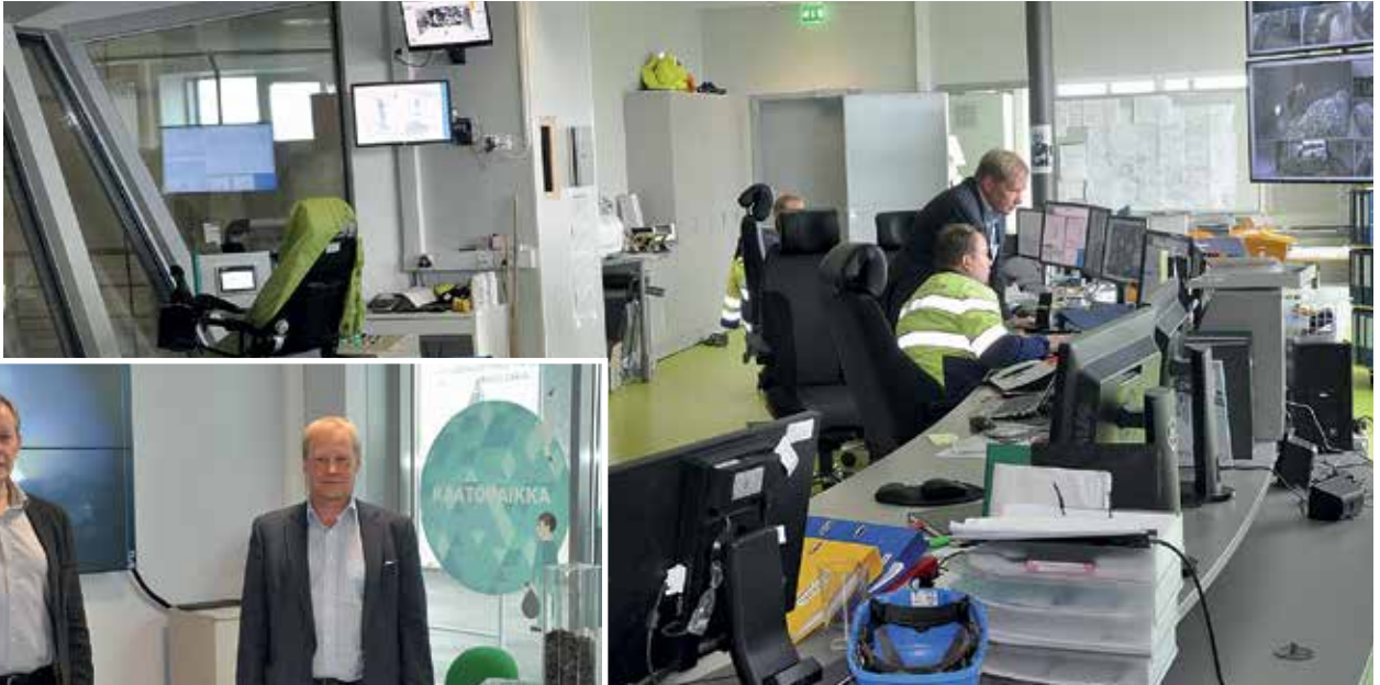
Voimalaitoksen valvomo on valoisa ja siisti. Vasemmalla olevan lasiseinän takana on jätebunkkeri, johon jäteautot tyhjentävät lastinsa ja josta jäte siirretään kahmareilla kattilan syöttöön.
