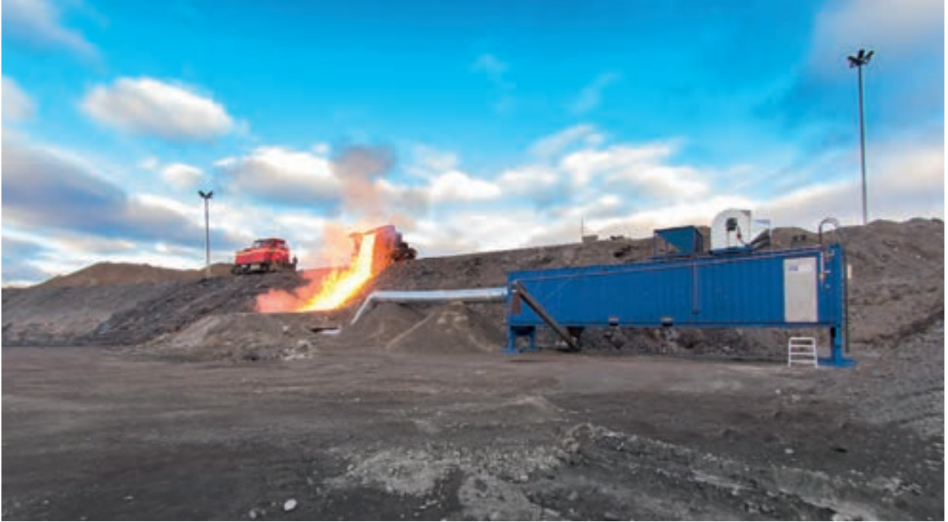
Kuva 3. ModHeat-kuivaimen pilotointi konverterrilietteen kuivauksessa.
