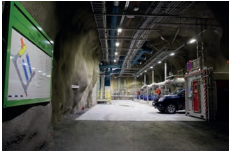
Kuva 5. Yara Siilinjärven kaivoksen maanalainen pumppaamo.
