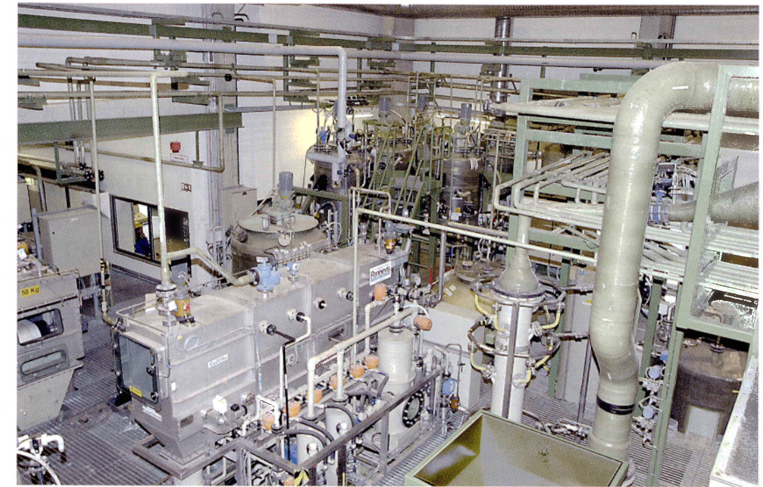
Kuva 7. Sisäkuva demonstraatiolaitoksesta. Fig 7. Interior of HydroCopper™ Demonstration Plant.
