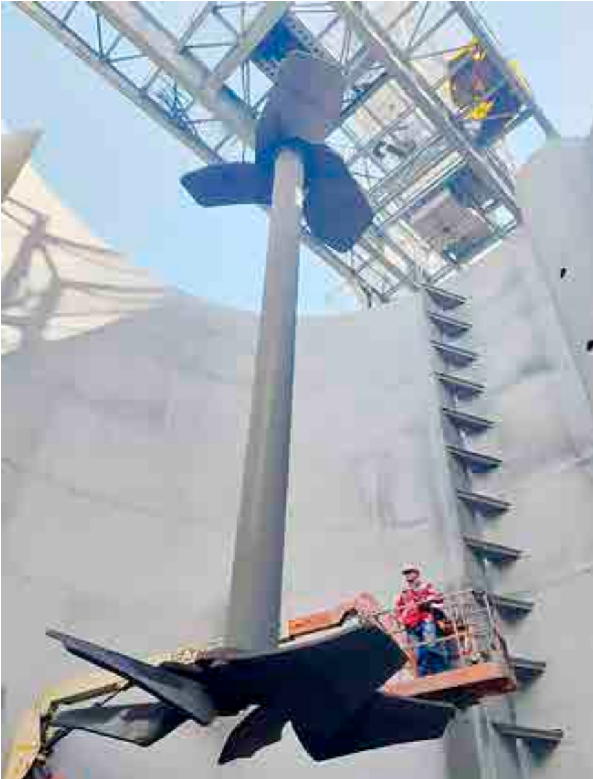
Metso Outotec on kustannustehokkaiden sekoitusratkaisujen kehittäjä ja toimittaja. Kuvassa OKTOP-sekoittimen asennus kullan syanidiliuotuslaitoksen esihapetusreaktoriin.
